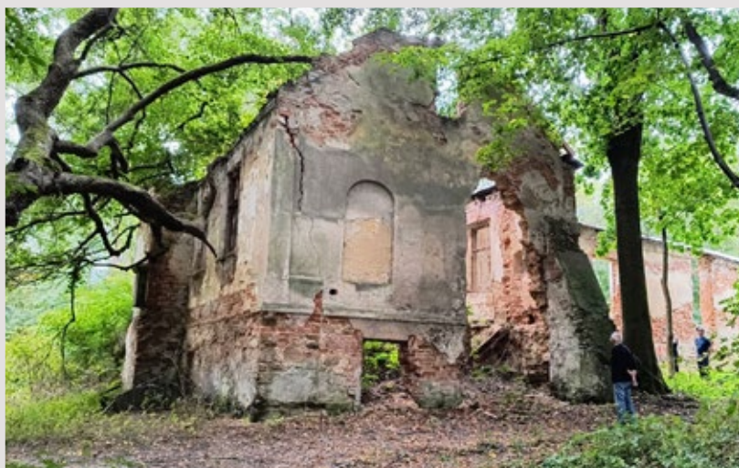
Ruiny wspaniałego niegdyś dworu Boguszków Siedliskach
